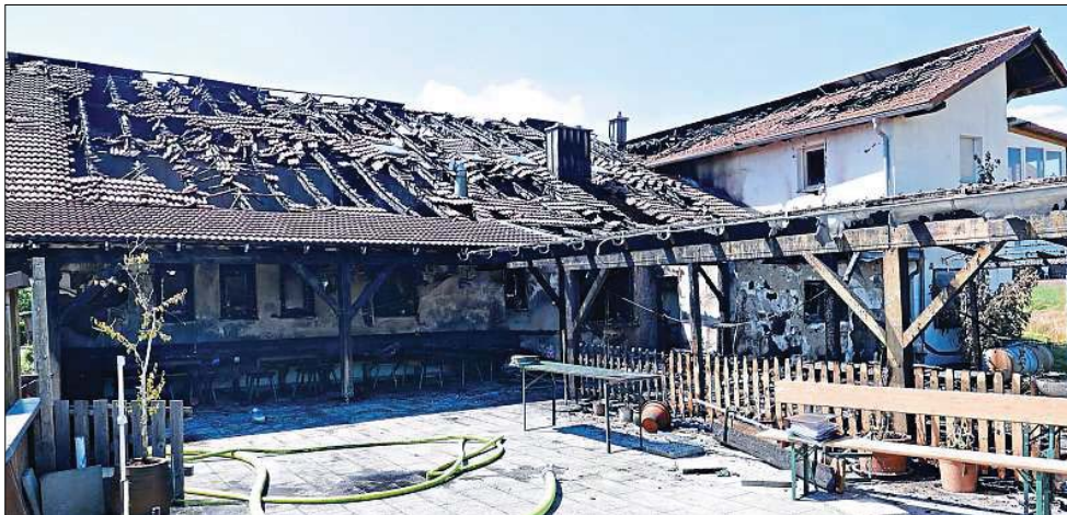
Ein Bild der Zerstörung bietet das Anwesen Ritzer in Oberdiendorf am Tag nach dem verheerenden Brand. Das Gasthaus (links) wurde ebenso ein Raub der Flammen wie der Anbau (rechts) und die überdachten Sitzplätze auf der Terrasse. – Fotos: Preuß
